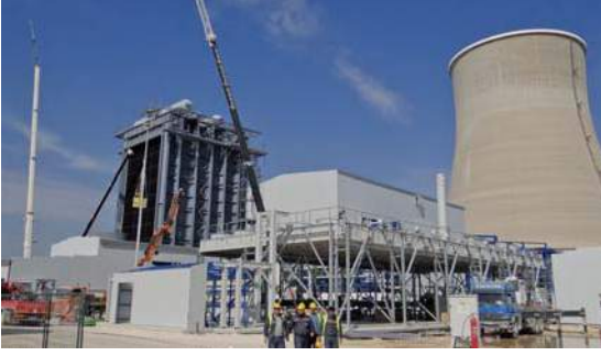
44 Hamitabat 1200 MW Doğalgaz Kombine Çevrim Santrali
