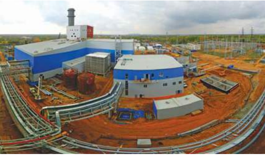
48 Kazanskaya 390 MW Doğalgaz Isı Güç Kombine Çevrim Santrali
